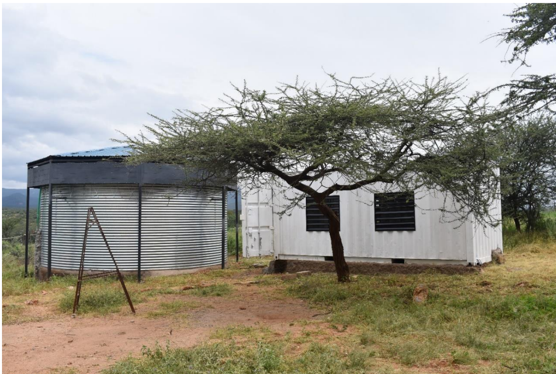
Grote drinkwater buffer tank met techniek container
