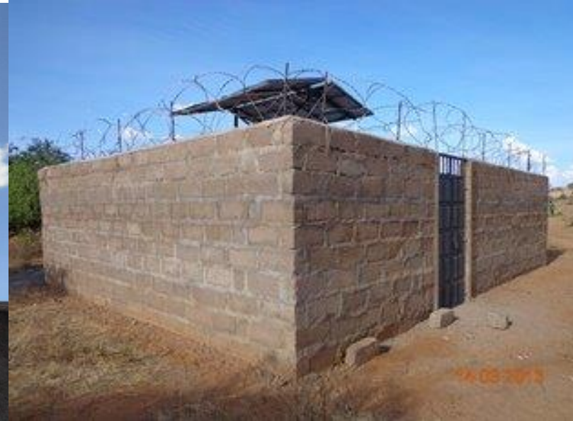
Bouwkundige beveiliging pomp en solar
