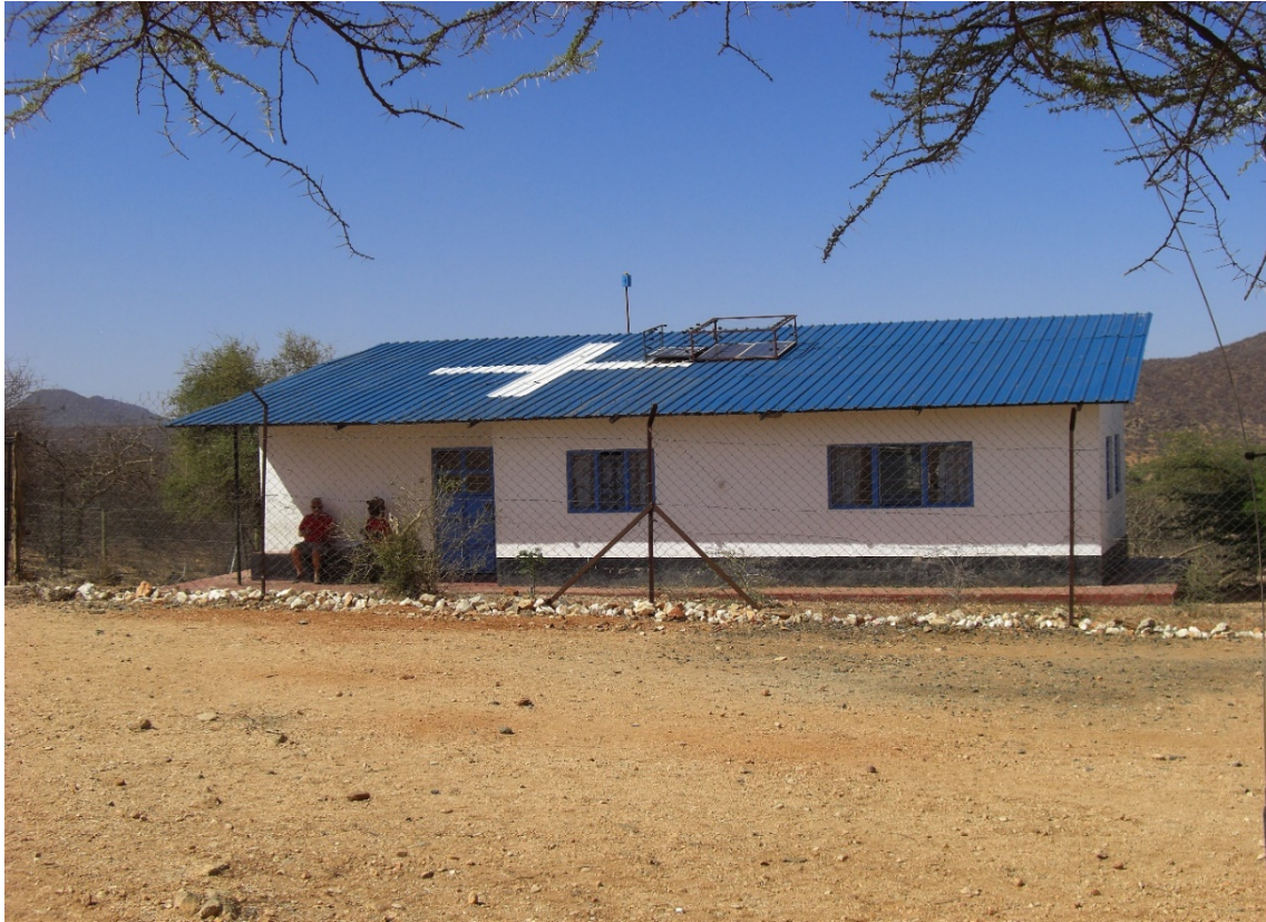
Zonnepaneel op dak Clinic voor de benodigde energie
