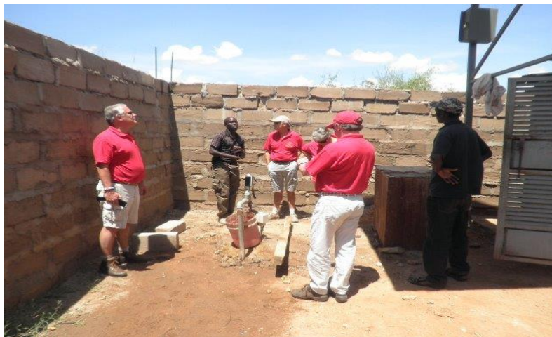
Binnenruimte met pompschacht
